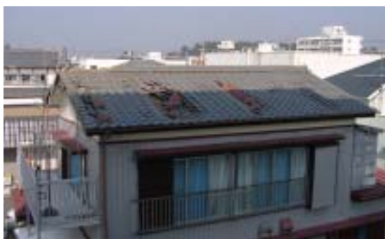
写真 17 住宅屋根瓦の飛散 (住宅 A)
