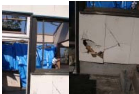
写真25 宿泊施設の窓ガラス、サッシ被害 宿泊施設の外壁に残る飛散物衝突跡
