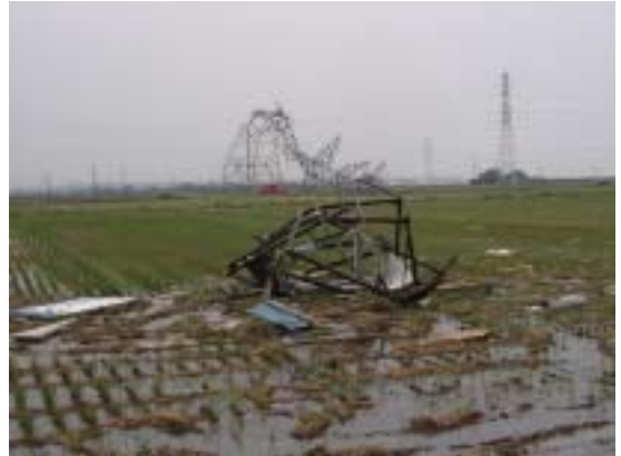
写真 12 香取線 21 号鉄塔付近の物置の飛散
