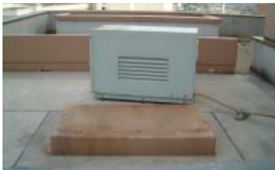
写真 16 鹿島セントラルビル屋上での室外機の転倒
