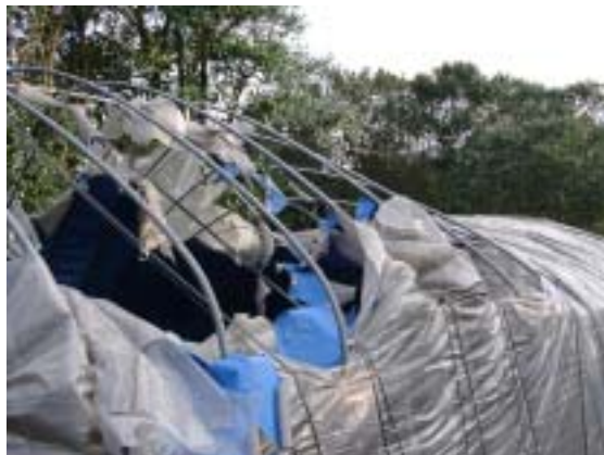
写真 30 ビニルハウスの被害
