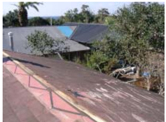
写真26 宿泊施設からの飛散物によって隣接する住宅の屋根に発生した被害
