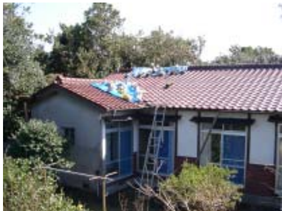
写真 27 隣接する家屋の屋根瓦の被害
